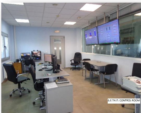
Εικόνα 7. Θάλαμος ελέγχου (control room) του κεντρικού αντλιοστασίου.
