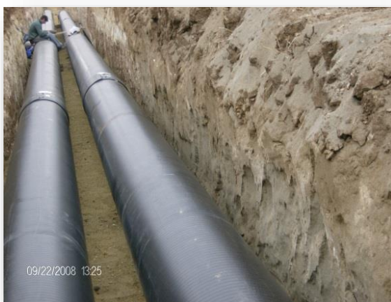
Εικόνα 2. Αγωγοί Μεταφοράς ΑΗΣ Καρδιάς.
