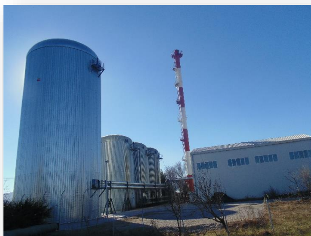
Εικόνα 5. Δεξαμενές αποθήκευσης θερμικής ενέργειας
