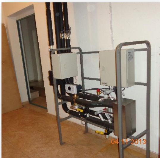
Εικόνα 6. Θερμικός υποσταθμός καταναλωτή - έμμεσο σύστημα.
