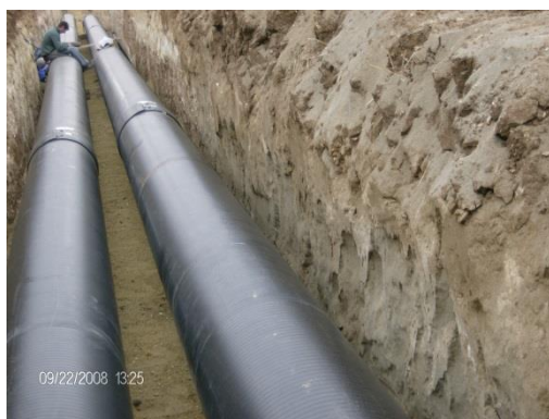
Εικόνα 2. Αγωγοί Μεταφοράς ΑΗΣ Καρδιάς.
