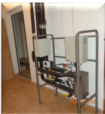
Εικόνα 6. Θερμικός υποσταθμός καταναλωτή - έμμεσο σύστημα.
